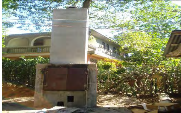
Photo 20 : Incinérateur du dispensaire Eben-Ezer
