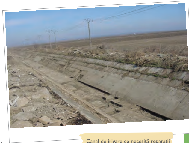
Canal de irigare ce necesită reparații
