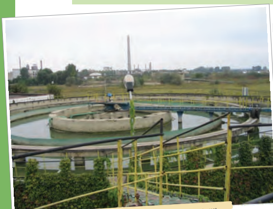
Stația pentru tratarea apei uzate din Brăila
