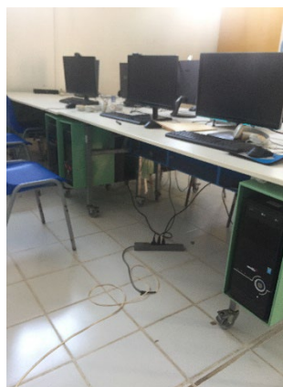
Curimana. Conexiones eléctricas sueltas
