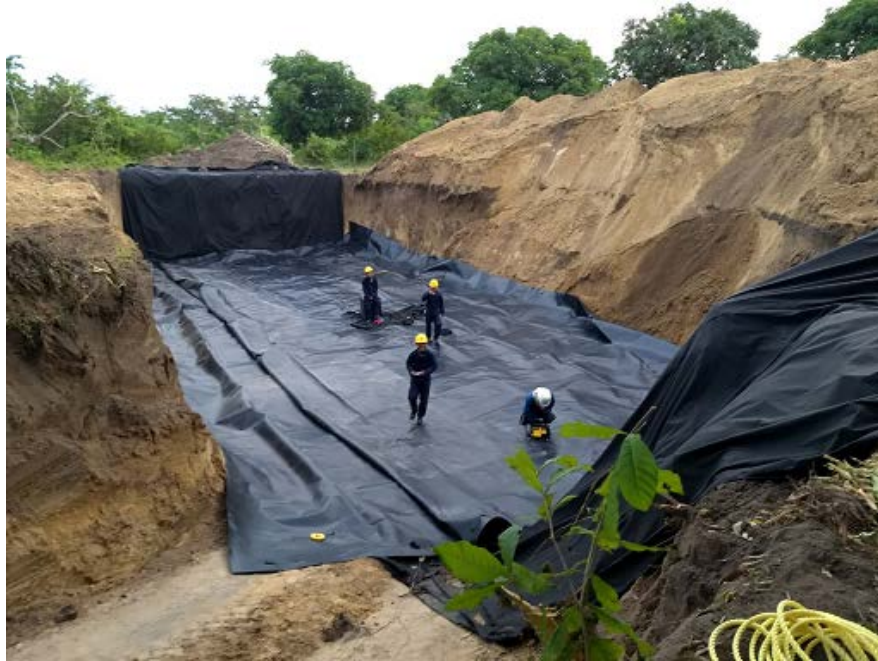
Celda de encapsulamiento para material de escoria contaminado con plomo
