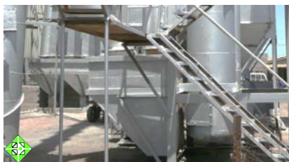
Torre de Lavado
