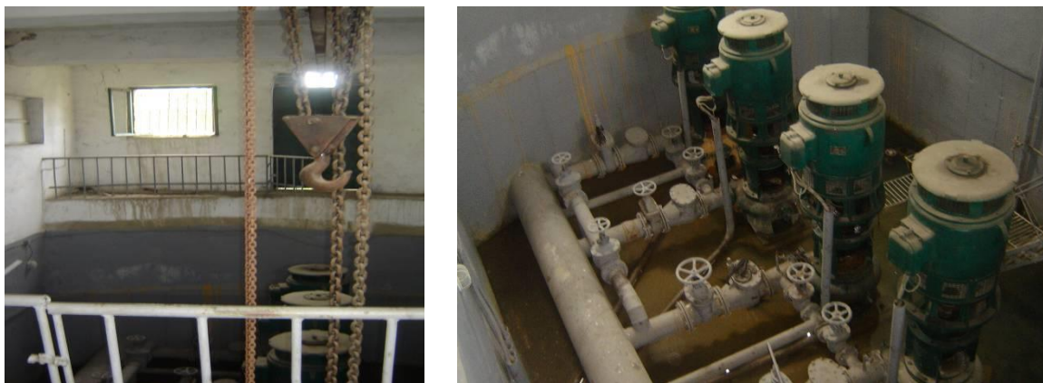
Figura 17. Stacion i pompimit të ujërave të ndotura
