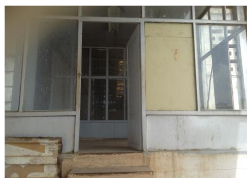
Porte secondaire à renforcer
