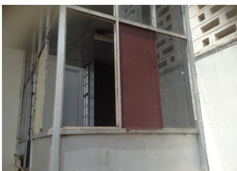
Porte secondaire à renforcer
