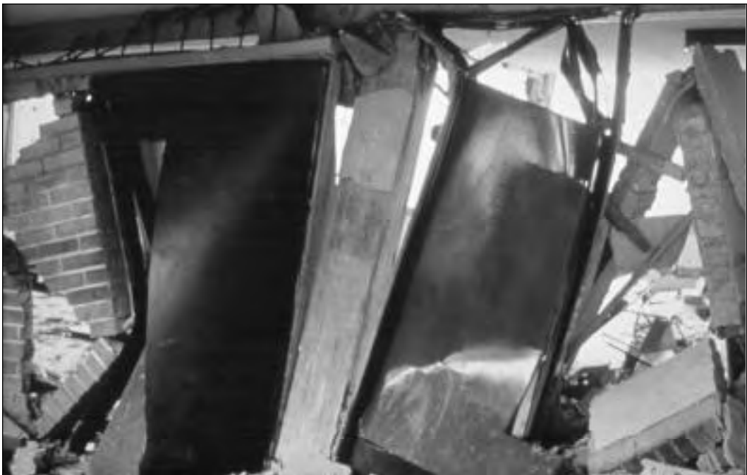
Fotografía 5. Falla de columnas por falta de sismorresistencia
