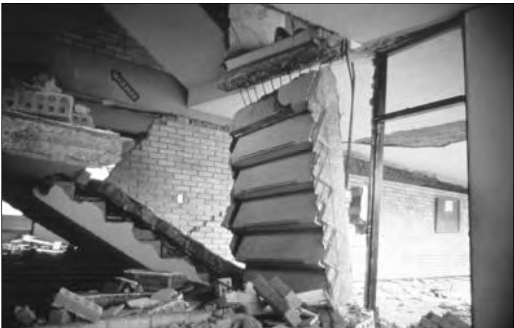
Fotografía 6. Colapso de escalera por falta de sismorresistencia, que evita cualquier tipo de evacuación.
