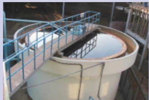
Effluent Treatment Plant (ETP)
