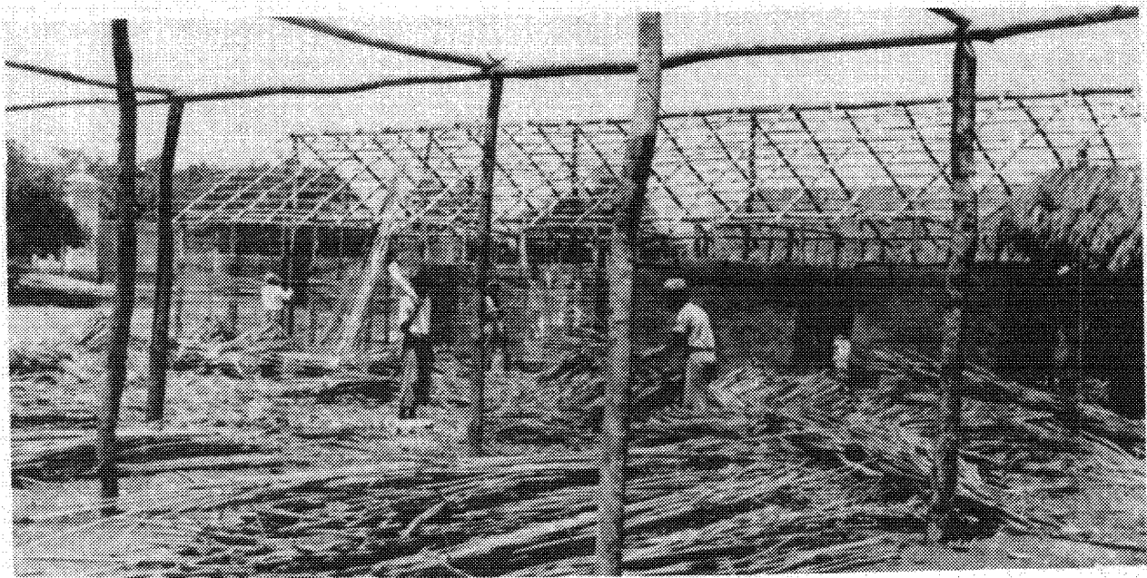
Figura 3. En Venezuela se construyen rápida y económicamente refugios de emergencia, para los damnificados de las inundaciones, con una especie de bambú nativo de la región: Guadua paniculata . La construcción se hace totalmente de bambú, exceptuando los postes de sustentación, que son de madera maciza. Para el acabado de los marcos se utiliza barro.
