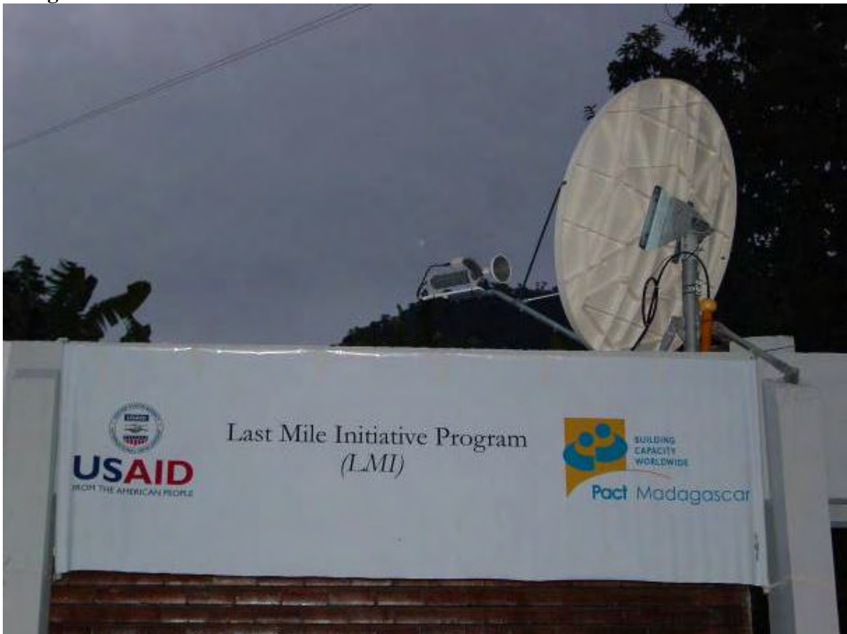
Installation VSAT à Ranomafana
